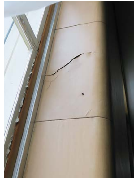
Exemple de dégradation des panneaux en cuir proches des fenêtres, exposés à la lumière et à la chaleur.
