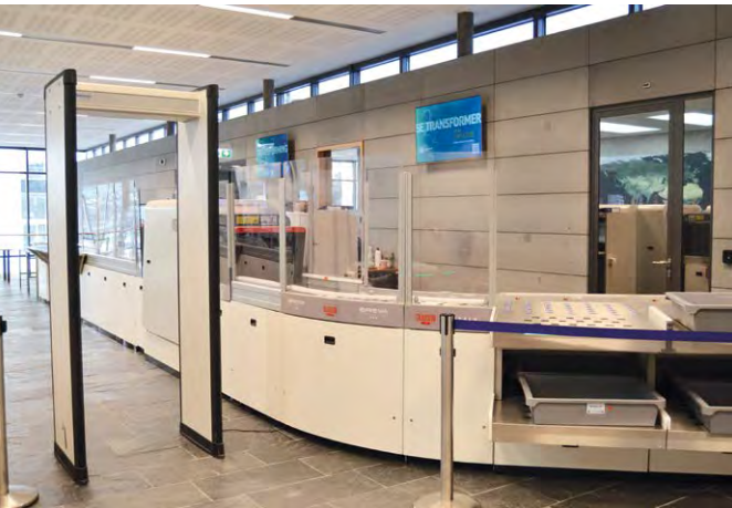
Plusieurs scanners à rayons X ont été installés dans le cadre de la modernisation du pavillon de Pregny, ce qui permet un contrôle approfondi et efficace à l'entrée. ©Photo ONU
